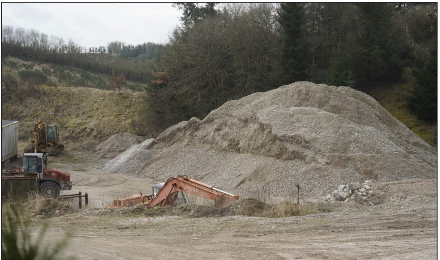
Matr. 4d - 2021: Knust beton oplagret i en enorm bunke i den gamle grusgrav i Skatskov.
